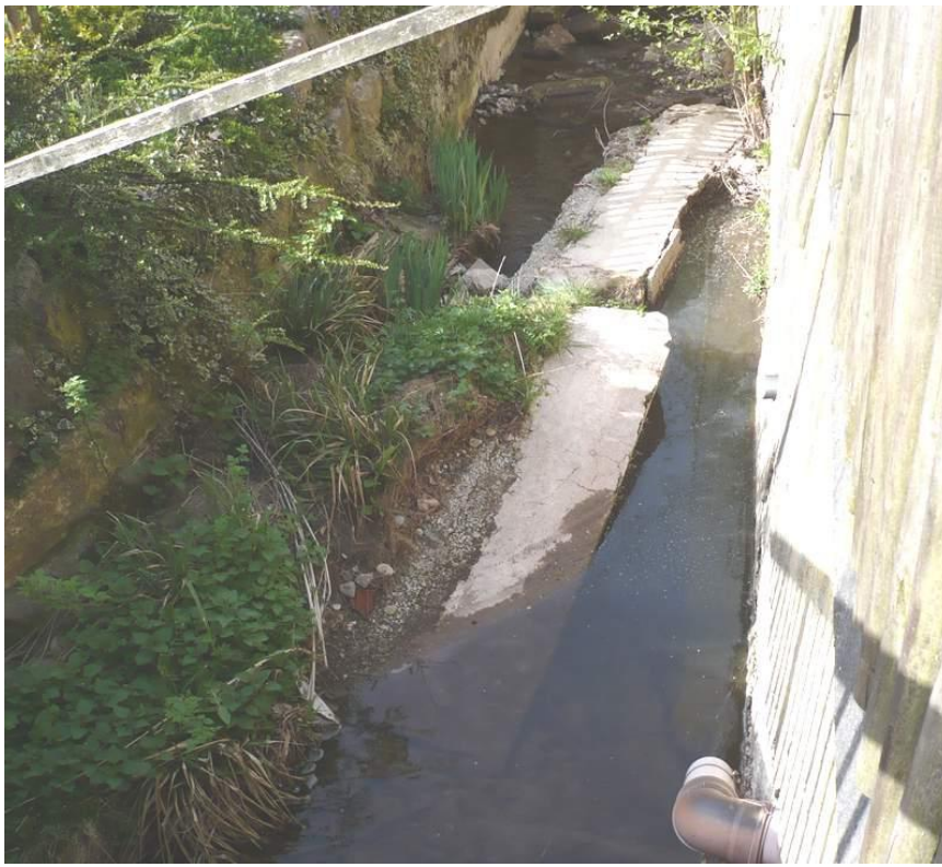
Eingefallene Stützmauer im Heslachbach (2005), Foto Frühjahr 2011
